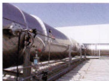
消臭剤スプレー脱臭装置
