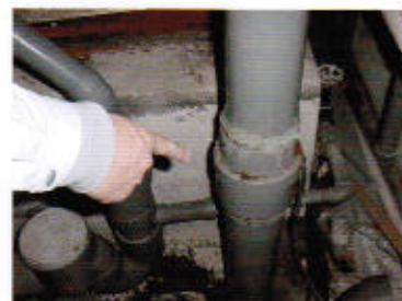
ここから汚水臭が漏洩
