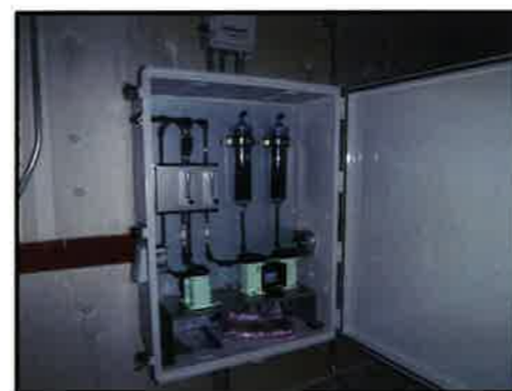
排気口希釈監視ユニット
