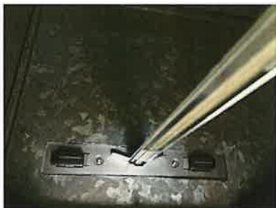
ダクト内から見たイメージ
